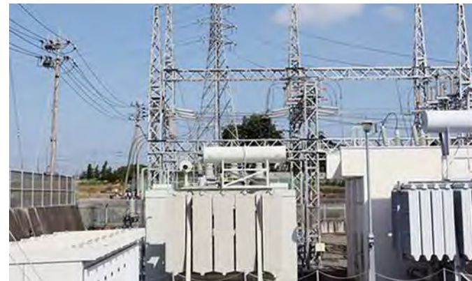
変電所や鉄塔
