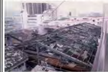
火災で吹き飛んだ屋根
