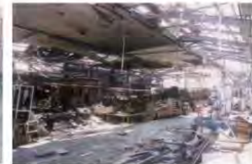
焼損した施設の状況
